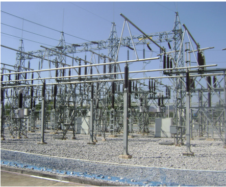
ลานไฟฟ้า
