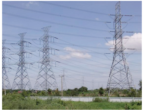
เสาไฟฟ้า
